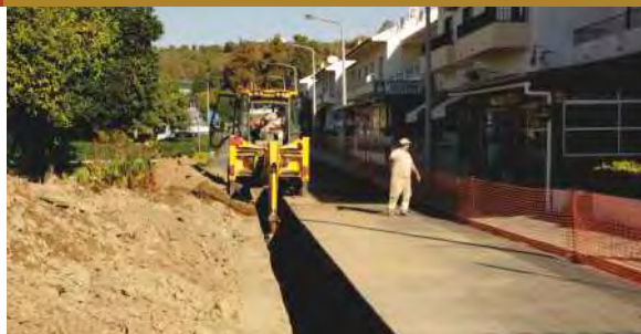
Coletor de Esgoto em Mértola
